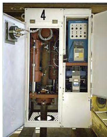
ジャッキ制御室
