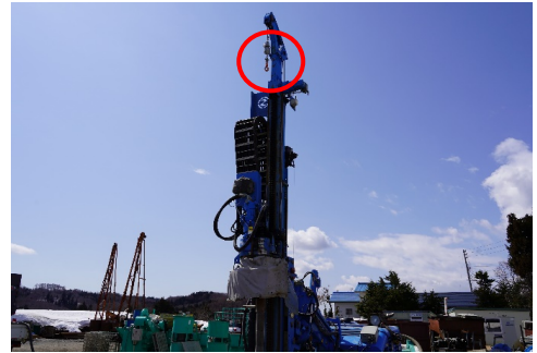
図-2 DTH 上部に設置した加速度計
