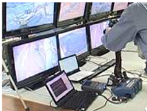
操作室に時刻を表示したPCを設置する
